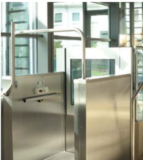
Bild oben: Aufzugsanlage, weitere technische Anforderungen enthält die DIN EN 81.
