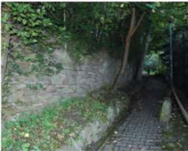
Zustand des Weges im oberen Bereich
