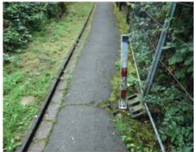
Zustand des Weges im oberen westlichen Bereich
