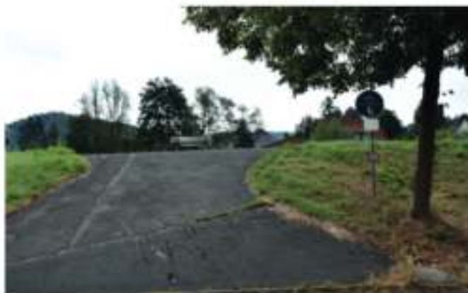
zu steile Rampe
