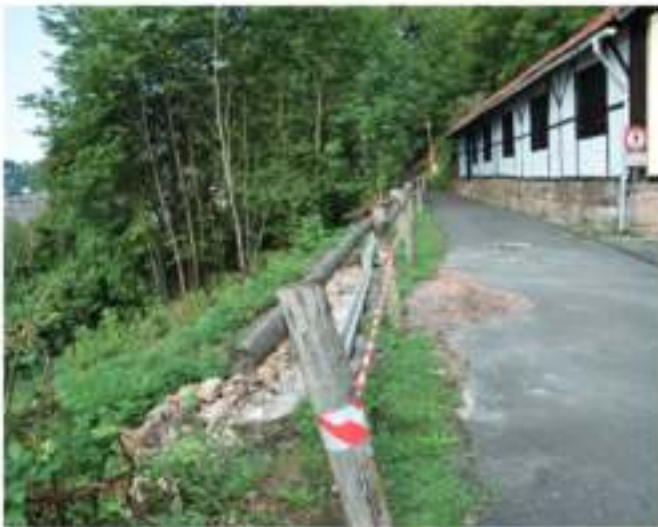
abgängiges Geländer auf Höhe des Schützenhauses
