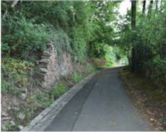
Verfall der Trockenmauern im unteren Teil des Weges
